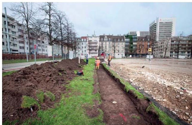
ABB. 33 Begleitung des maschinellen Aushubs eines Leitungsgrabens im Randbereich der Voltamatte. Foto: Margit Dauner.
